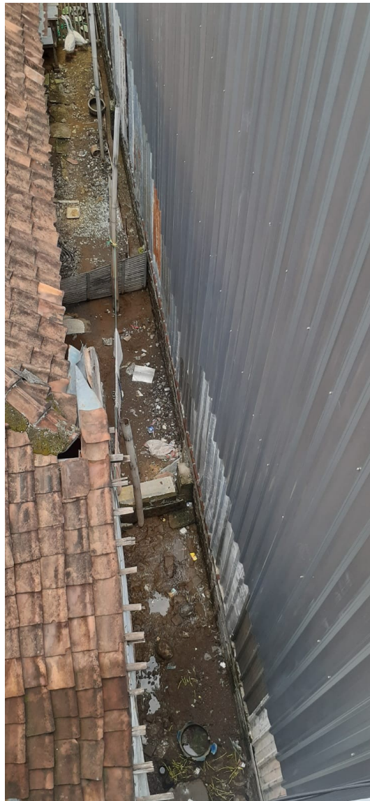
Tembok/dinding yang rusak/jebol sudah diperbaiki oleh Perusahaan
