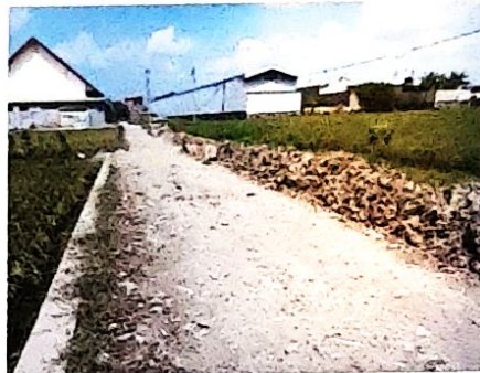
Kondisi tumpukan material di pinggir jalan
