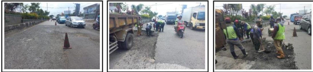
PEKERJAAN PEBAIKAN LOKASI BANJIR PENINGKATAN ASPAL MENJADI RIGID RUAS JALAN BTS. KAB. DEMAK/KUDUS – JATI (KUDUS) KM 46+200 KA
